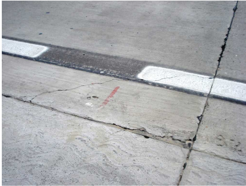
Fotografía 3. Fisuras en esquina de losa
