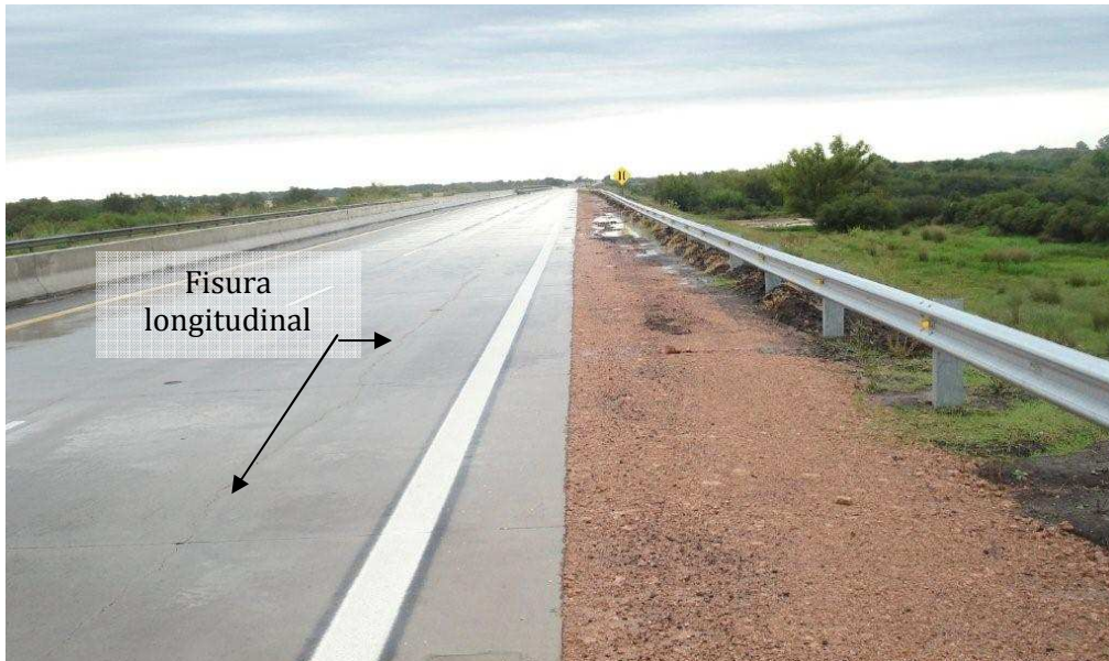
Fotografía 2. Desarrollo de fisura longitudinal por influencia del suelo de apoyo.
