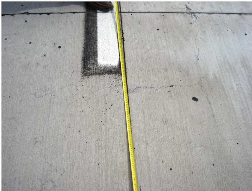
Fotografía 1. Vista de fisuras de contracción.
